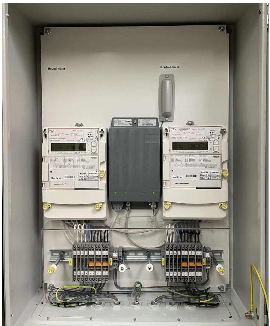
FIG 2 (Billedet viser installation med kommunikationsudstyr og klemmer for hjælpespenning umiddelbart under måler)
